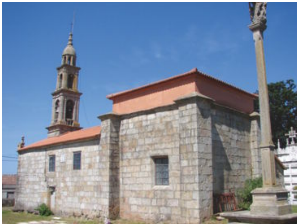
Vista exterior da igrexa de Zas: muro sur (1848), presbiterio cos seus contrafortes do séc. XVII e co engadido innecesario de 1984-1987 (foto XMLS, 2016)
