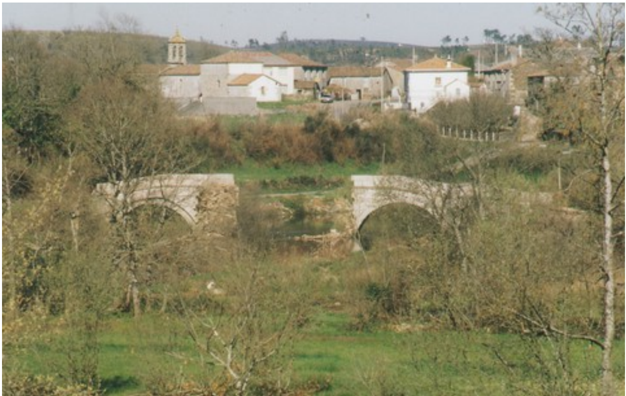
Vista de Brandomil despois de que as inundacións de decembro de 1989 derrubasen o arco central da Ponte Vella [foto XMLS]
